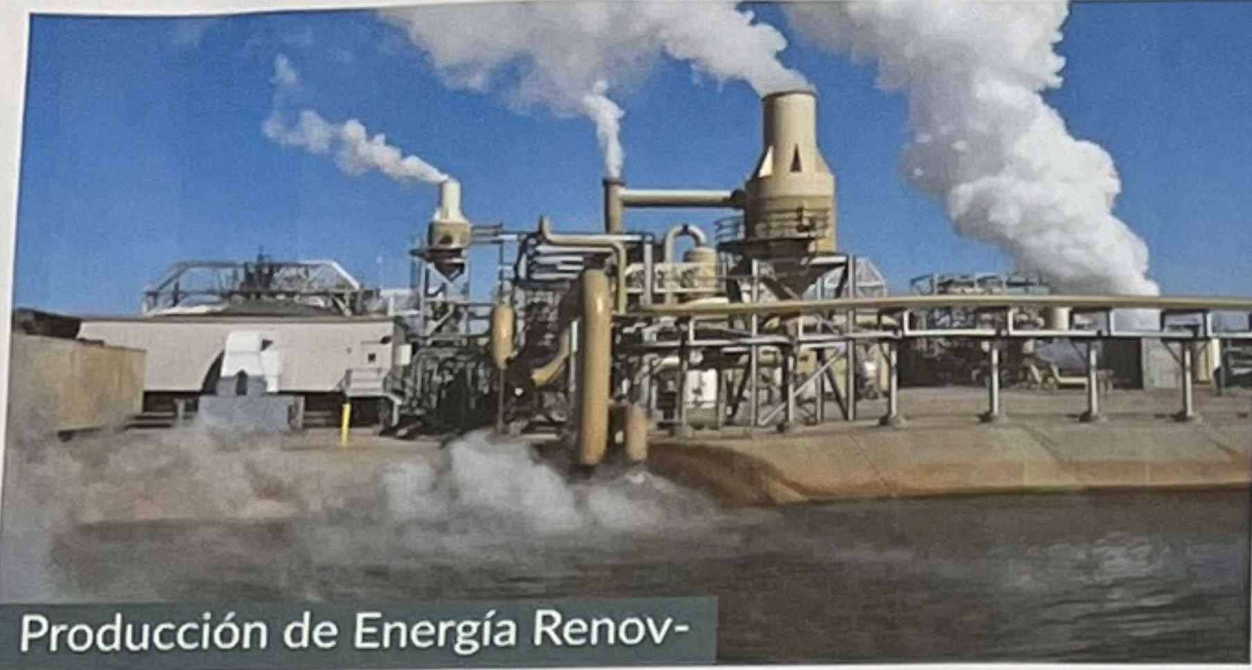
Producción de Energía Renov-
